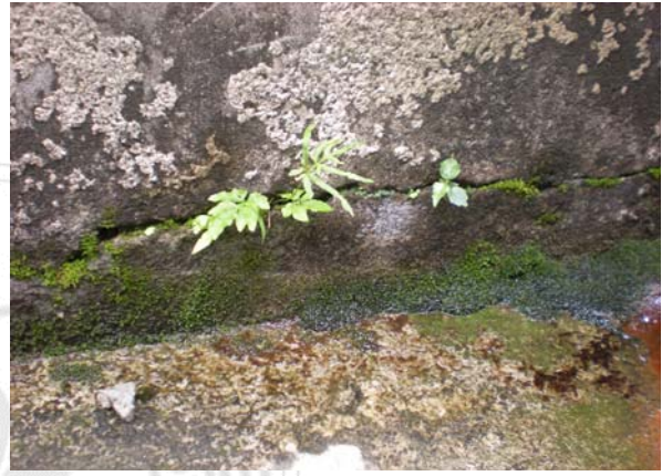
圖 3-8 牆壁裂縫的植物/作者自攝
