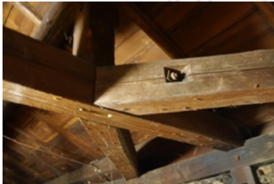
圖2-2-12 Y6 火打梁現況照片
