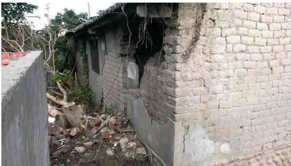
圖 4-4 第一棟土埆厝西側牆面窗戶未施工前 資料來源：蔡佳君小姐提供
