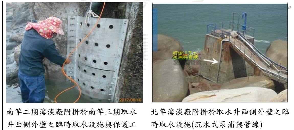
圖 3.11 附掛於取水井外之臨時取水設施
