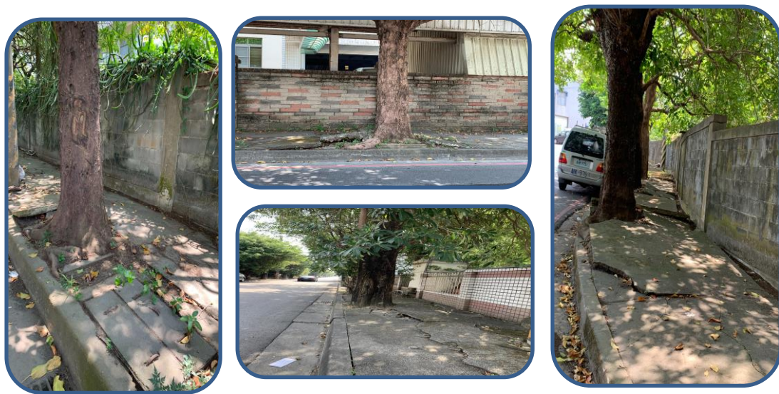
圖 4-1 樹穴狹窄行道樹根系破壞人行道鋪面
