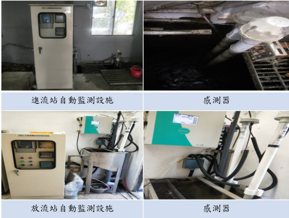
附圖 1 新北污水廠自動監測設施
