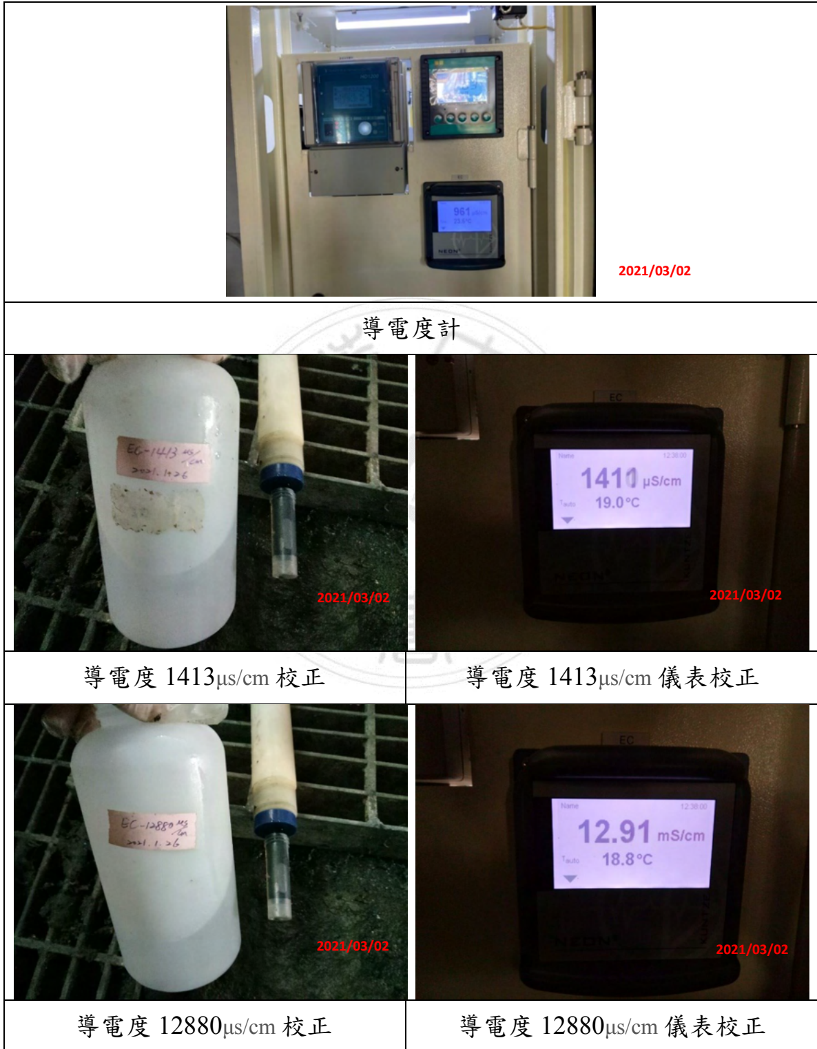
附圖 13 自動監測感測器-進流導電度 EC 維護校正
