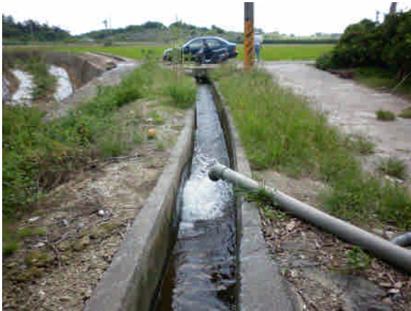
圖2.28 注入溝渠的地下水
