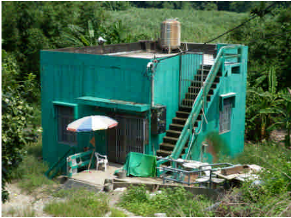
圖2.26 嘉南農田水利會詔安厝抽水站 本抽水站位於頭前溪左近，埋設管線入溪，用以抽取頭前溪水，以作為農田灌溉之用，是為本區農田的心臟。
