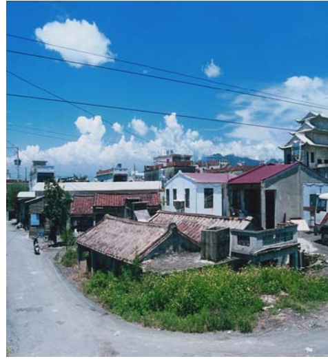
圖 3-7 林邊鄉房屋整村下陷
