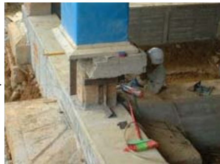
圖4-53建築基礎地樑結構之診斷與補強
