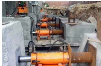
圖4-71安放千斤頂及應力擴散墊板 用千斤頂向前推移樓體 資料來源：新華網 2002
