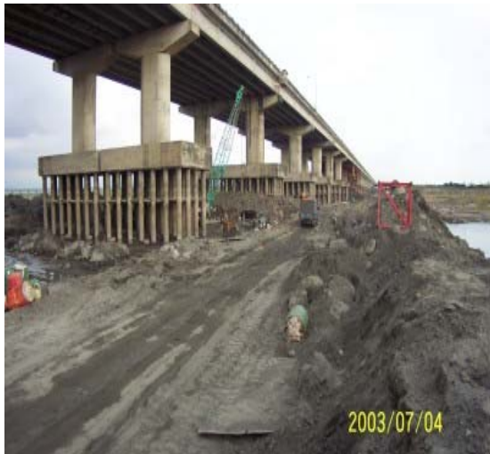
圖3-15彰化溪洲大橋千斤頂 支撐橋樑工程 資料來源: 南北樓房遷移公司照片 (2003)
