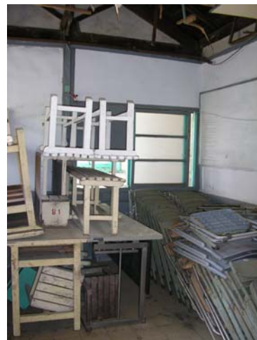
圖 38、C 棟內天花板破損，堆放雜物 （本研究攝）
