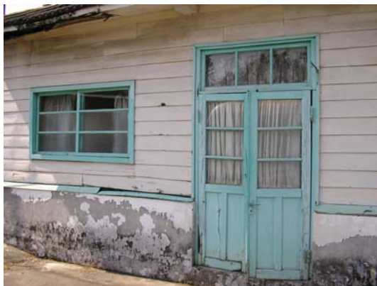
圖 35、被規劃為書店的 B 棟值日官室外觀 牆壁油漆剝落（本研究攝）
