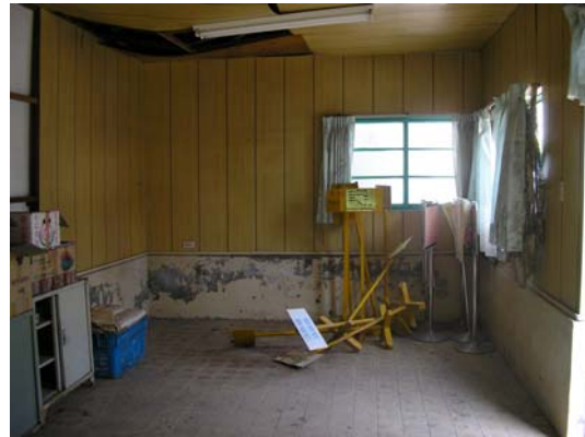
圖 36、B 棟室內天花板破損、堆放雜物 （本研究攝）
