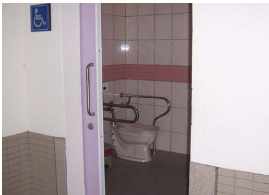
圖 5-23 殘障廁所設備
