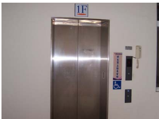
圖 5-25 殘障電梯設備
