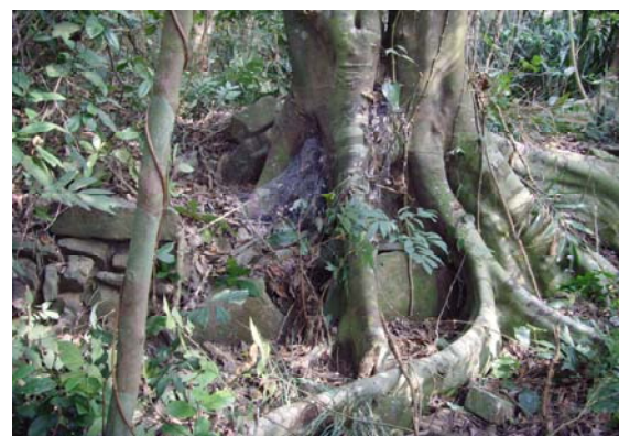
圖 2-64：大樹根滲透進石牆垣
