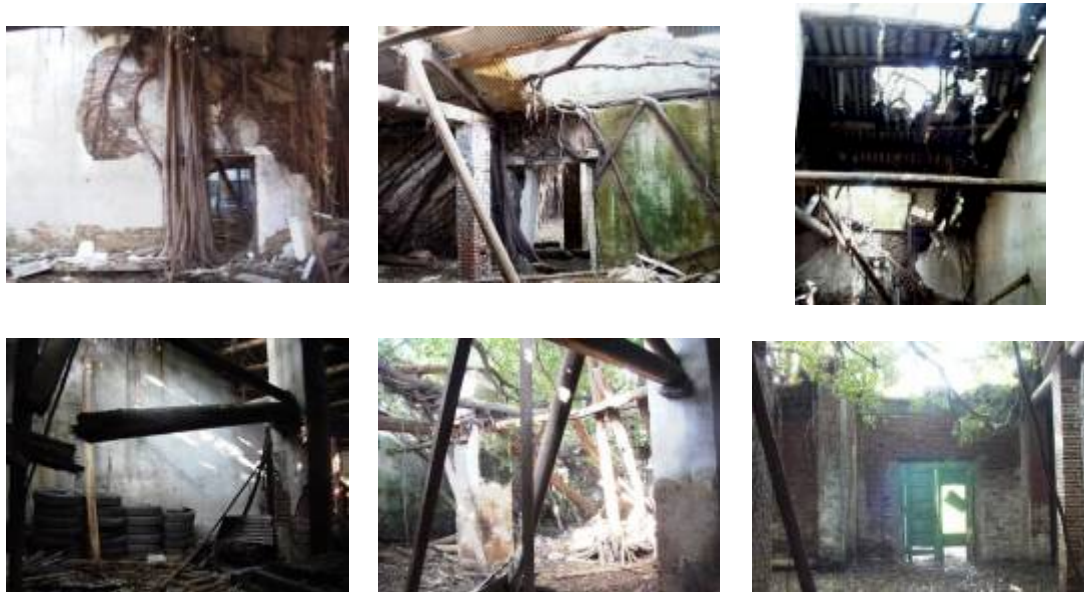
【圖4-2-8】安平樹屋已損壞的門窗與塌陷的屋頂（圖片來源：台南市文化觀光處提供）
