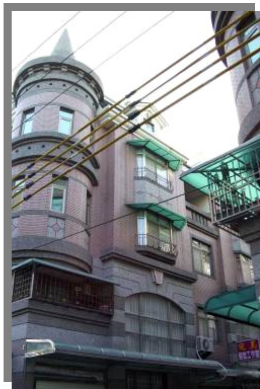
相片 4-13 住宅防雨措施現象（二） 本研究攝影
